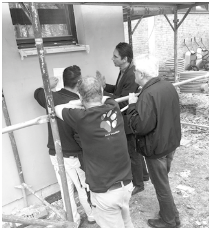
Architekt Dr. Witschurke und der Bauleiter Herr Dirschau besprechen mit den Handwerkern die Ausführung der Fassadenbekleidung.
